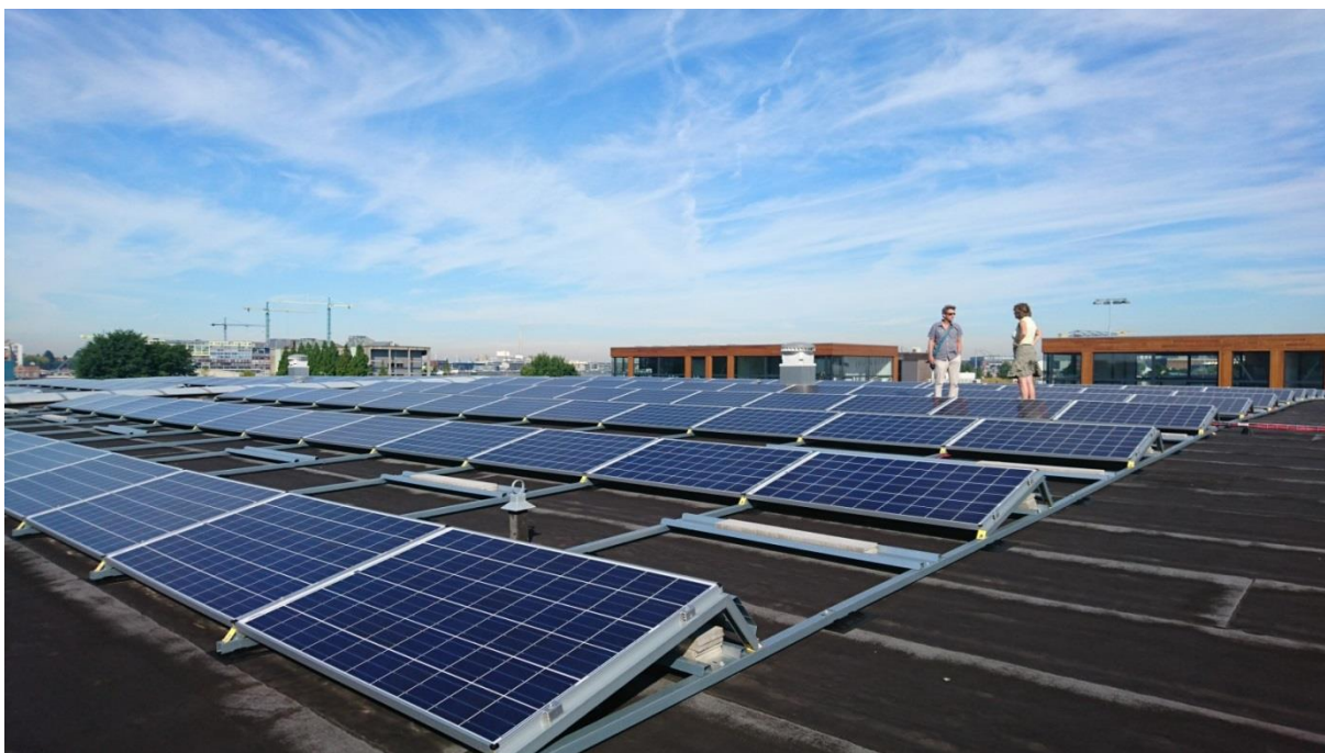
Figuur 6: Zonnepanelen op het dak van de Bouwmaat in Amsterdam Noord aan de Asterweg 37, 1031HM. Bron: http://www.ecostroom.nu/
