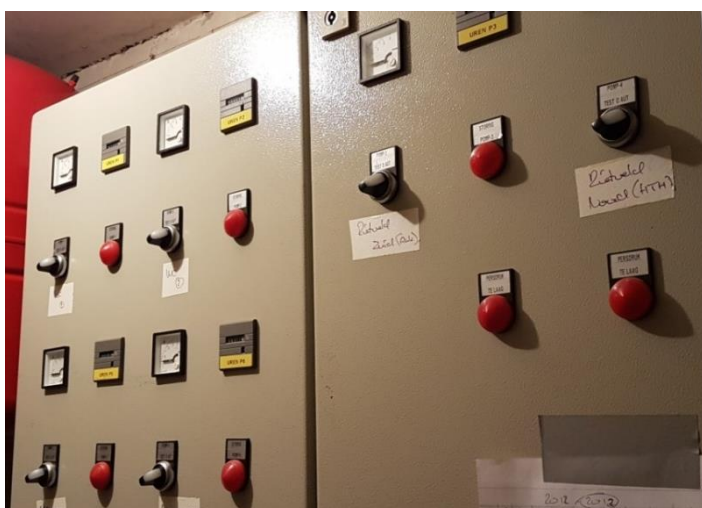
Figuur 19: De controlekamer van het helofytenfilter
